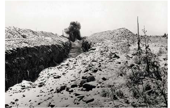
Utajärvellä oli valtavia räjäytyksiä 12 km pitkää alakanavaa louhittaessa. Ikkunat helisivät ja muurit halkeilivat taloissa kilometrien päässä. Kuva: Fortum Oyj:n kuva-arkisto
