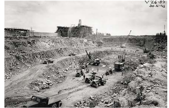
Etelä-Pohjanmaalta tulivat miehet autoineen urakoimaan voimalaitostyömaille. Louhoksen siirto käynnissä Jylhämässä. Kuva: Fortum Oyj:n arkisto
