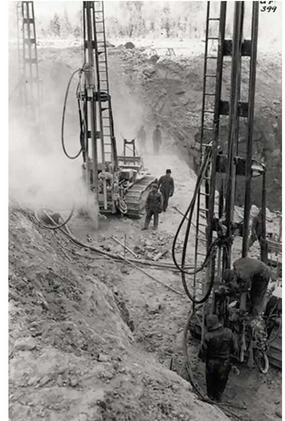
Maansiirto ja louhinta oli valtavan mittakaavan työtä. Vielä 50-luvulla henkilökohtaisia suojaimia ei paljoa käytetty. Kuulo meni, keuhkot täyttyivät kivipölyyn ja silmissä oli usein kivensiruja. Kuva: Fortum Oyj:n kuva-arkisto.
