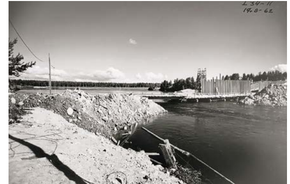
Leppikosken työmaa elokuussa 1962. Kuva: Fortum Power and Heat Oy. Kuvaaja: Foto Roos.
