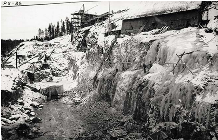
Talvirakentaminen oli haastavaa ja hidasta hommaa. Mitä kylmempää, sen vaikeampaa. Kuva: Fortum Oyj:n kuva-arkisto
